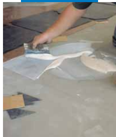
Exemplo de assentamento de PVC (embutido) sobre regularização em Ultraplan - CD 2 - Milão - Itália
